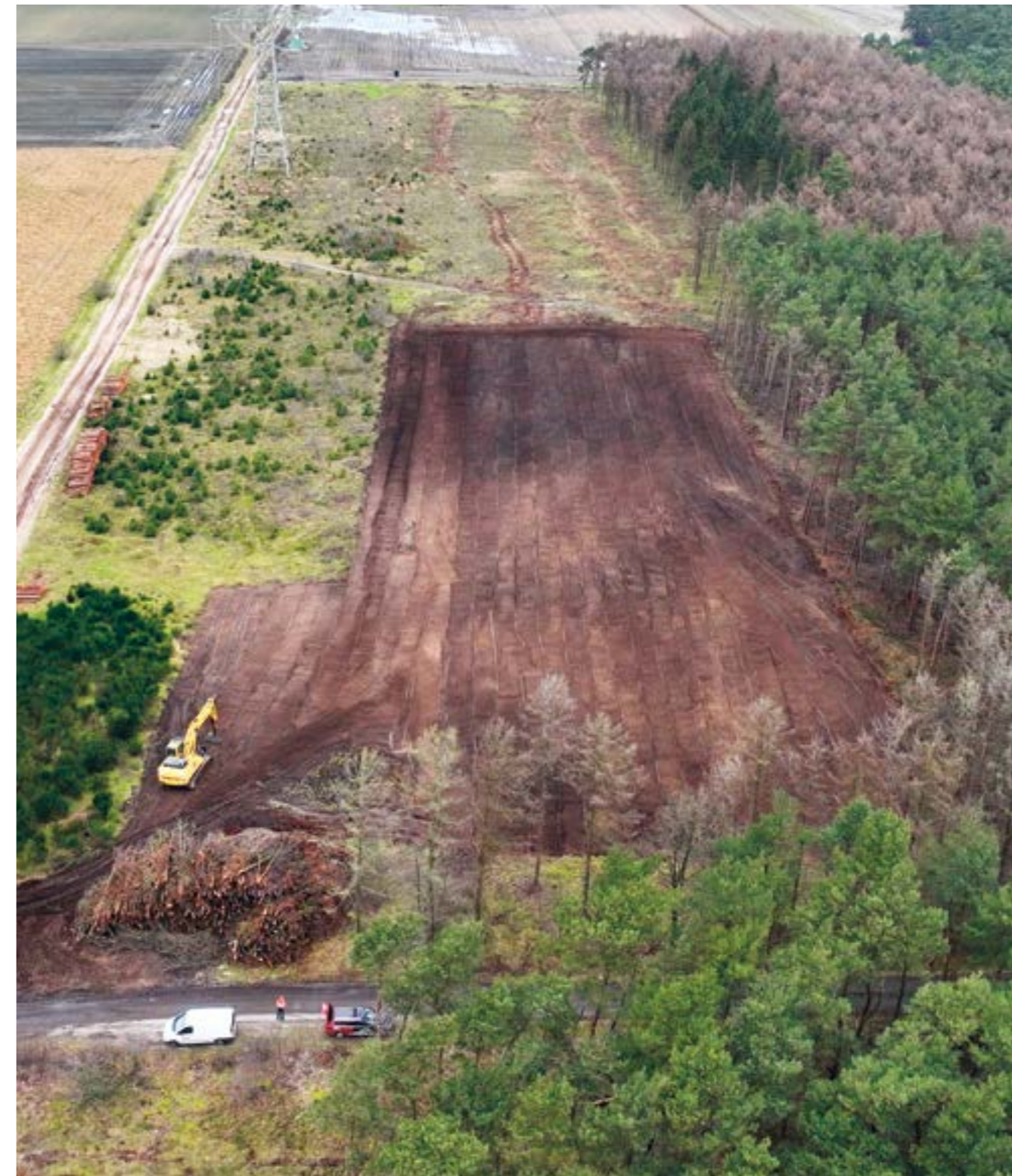
Im Erdkabelprojekt A-Nord kommt die HDD-Bohrung zum Einsatz. Hier wird die Fläche für die Startgrube eingerichtet.
